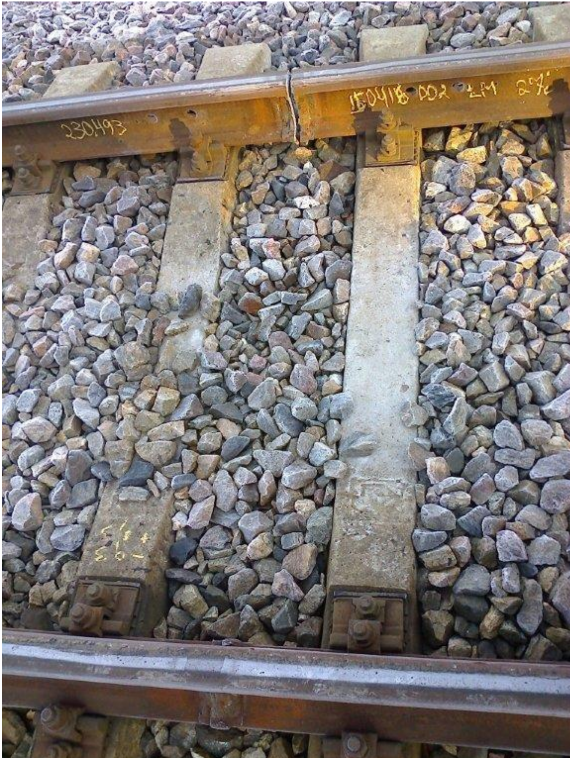
Foto 1. Rööpamurd 28.12.2015 termiitkeevises Kabala – Sonda jaamavahel km 229 pk 6
